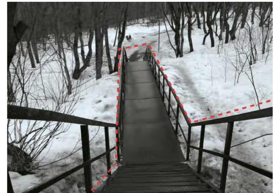
6. Наличие ветхих конструкций
