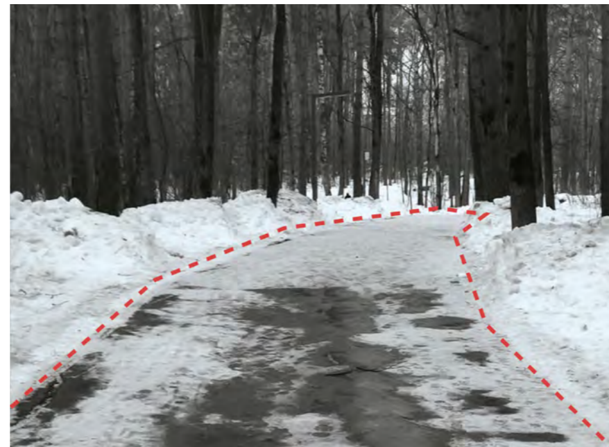
5. Отсутствует качественное покрытие на дорожках
